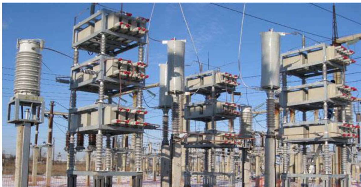
Рис. 82. Конденсаторная батарея установленная на подстанции
